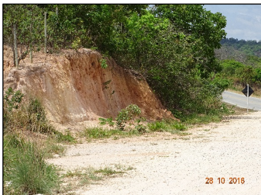
Figura 34. Talude com solo exposto.
