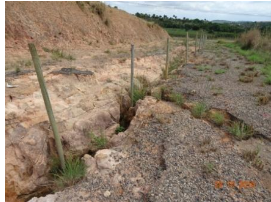
Figura 32 – Sulcos e processos erosivos
