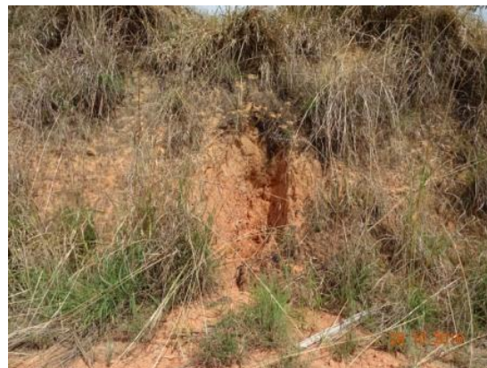
Figura 45 – Processo erosivo pontual
